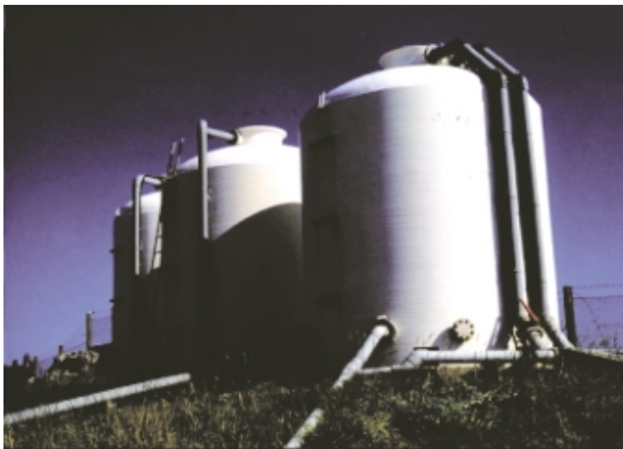
Figura 11 Depósitos generales de agua
